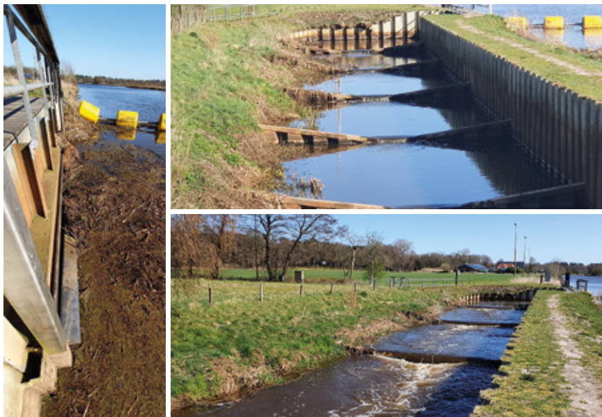
Figuur 6.35 a: Ingang vispassage Vilsteren verstopt met maai-afval (eind maart 2021). b: Door de verstopte inlaat stroomt nauwelijks water in de vispassage. c: Vispassage stuw Vilsteren, nadat de ingang was vrijgemaakt. Foto's: Gerwin Bonhof.
